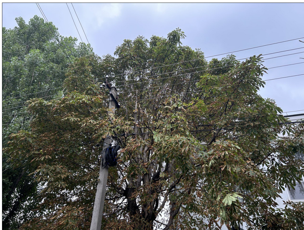
Опора № 13 ВЛ-0,4 кВ «Р. Люксембург нечетная», присоединенная к ТП 6/0,4 кВ «РГ-1-215», совместный подвес с ВЛ-0,22 кВ «Наружное освещение» присоединенной к ТП 6/0,4 кВ «РГ-3-5»
