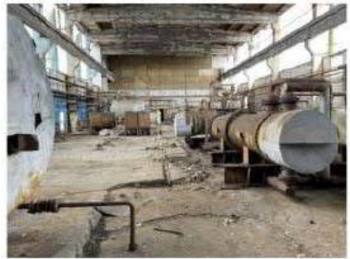
Ёмкости на 4-ом этаже здания 04 (Лит 207); общий вид.
