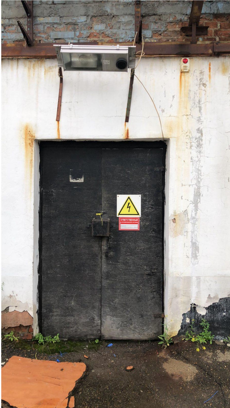
Действующая трансформаторная подстанция
