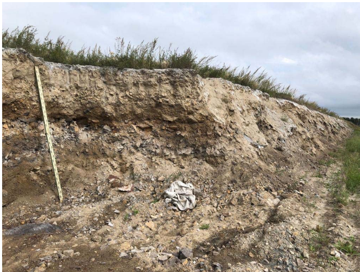
Рисунок 5.7.2.2 – Состояние дамб шламонакопителя
