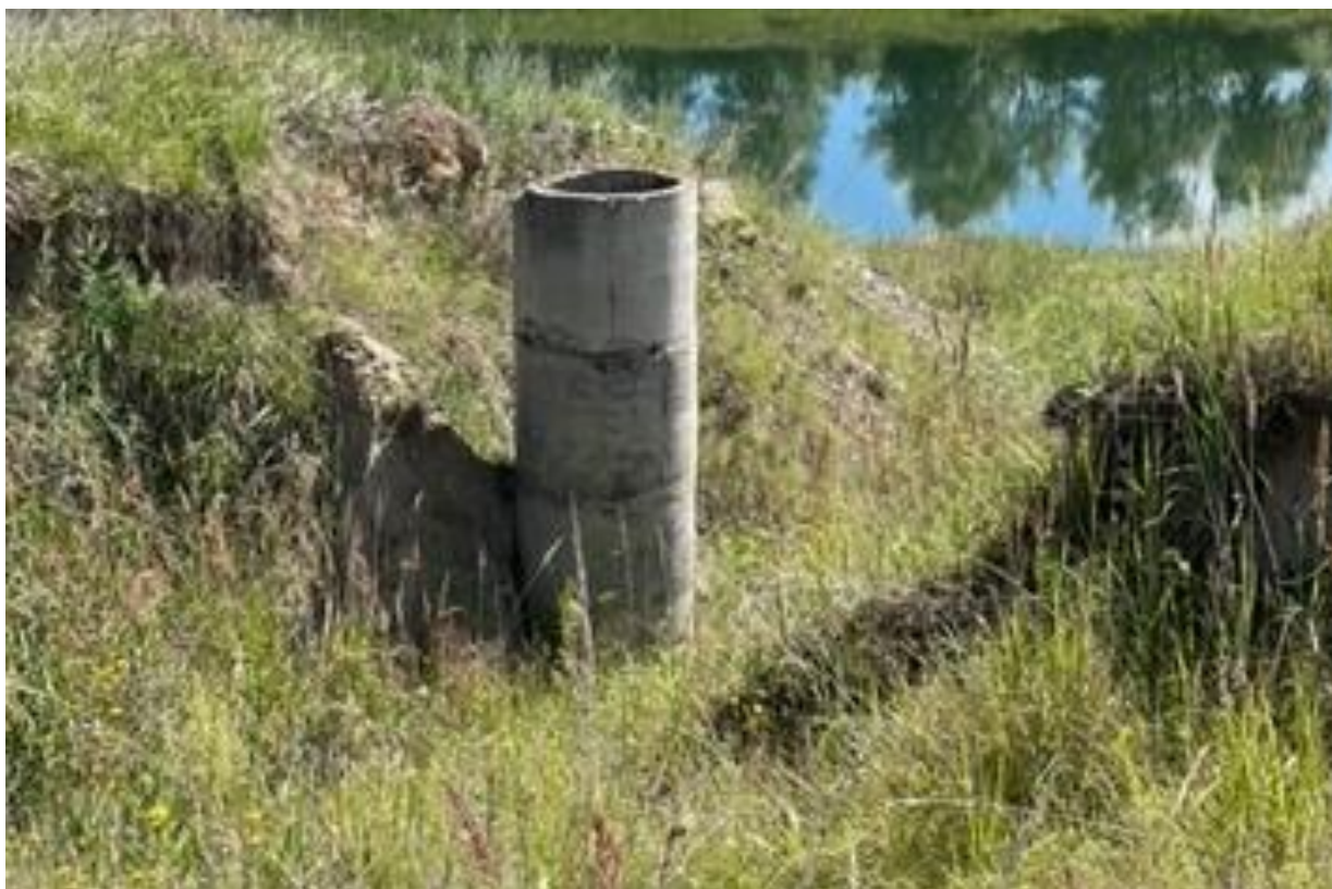
Рисунки 2...5. Сооружение Водозабор «Ангара». Колодцы дренажной системы.
