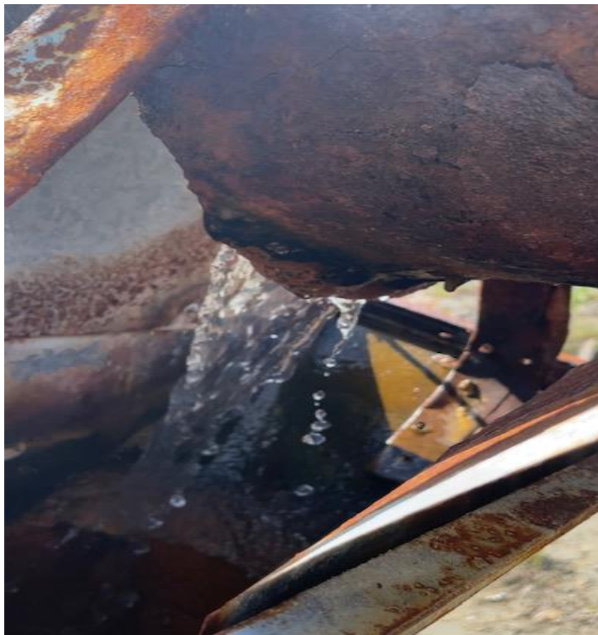
Рисунки 6...7. Сооружение Водозабор «Ангара». Нефтяная ловушка.
