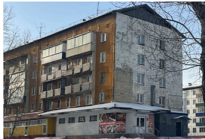
1 Дефекты фасадов жилых домов
